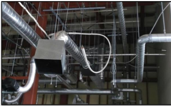
天井内ダクト配管の様子
